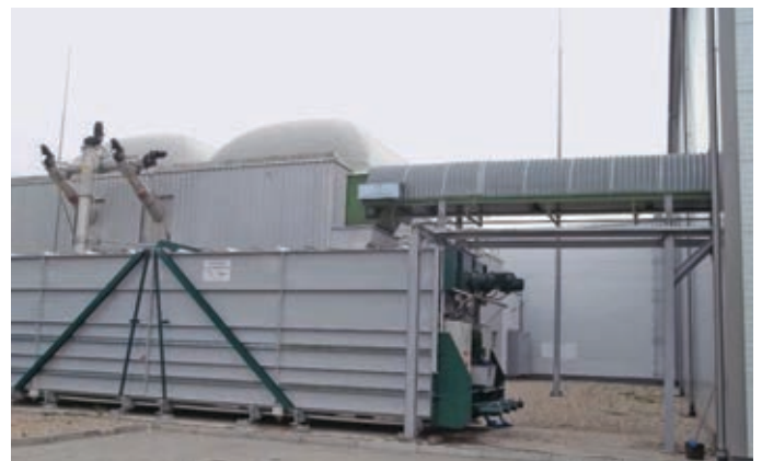
Biogasanlage Biala Podlaska.
