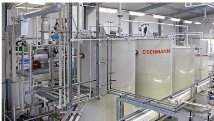
Anlage zur Pestizidbehandlung.
